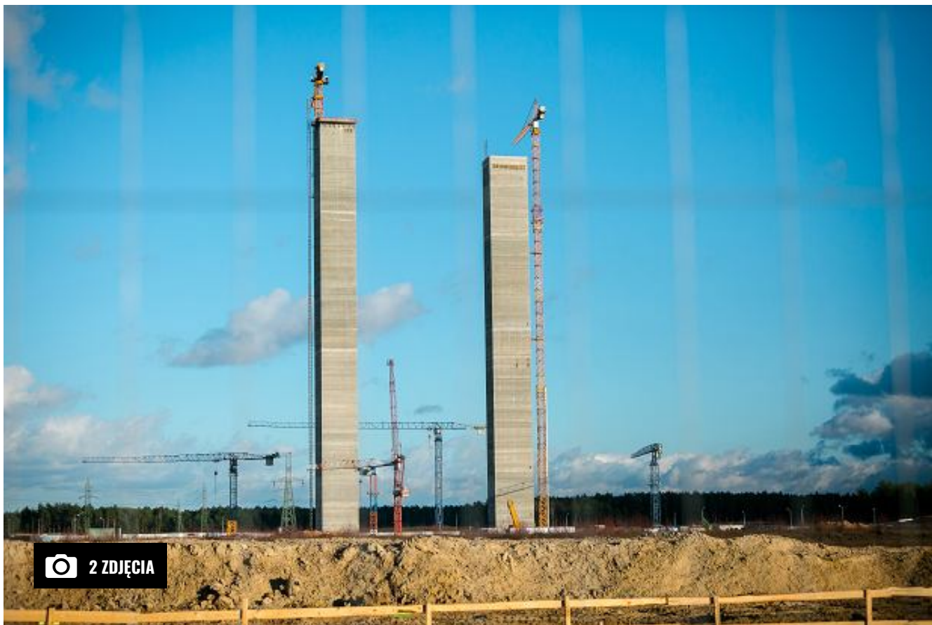
Elektrownia Ostrołęka. Budowa bloku C stanęła, pozostały dwie 'wieże Kaczyńskiego' Jaroslaw Sender / Jaroslaw Sender/East News
